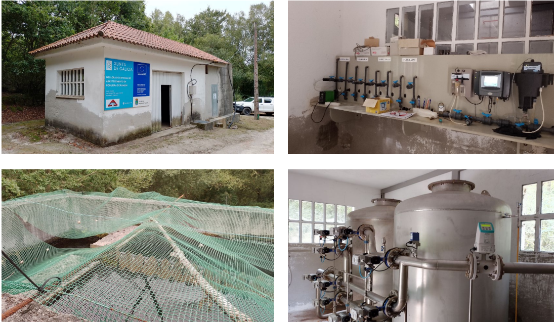
Figura 25. Instalacións do depósito de Loña (ETAP de Loña).
