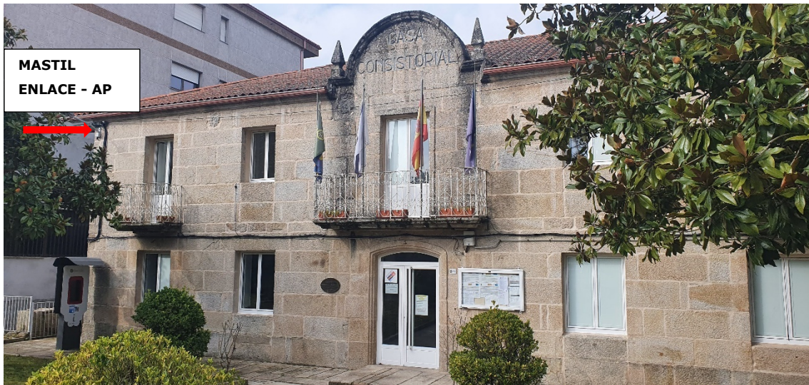
Foto 2. Emplazamiento Luintra Plaza Mayor (Rack Interior)
